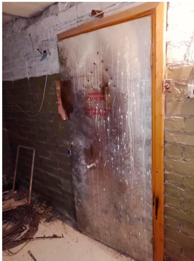
Рисунок 4– Вход в машинное помещение
