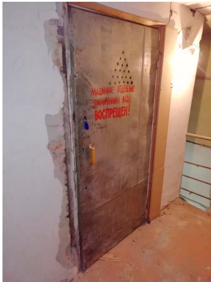
Рисунок 4– Вход в машинное помещение
