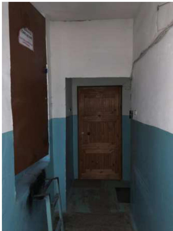
Рисунок 4 – Вход в машинное помещение
