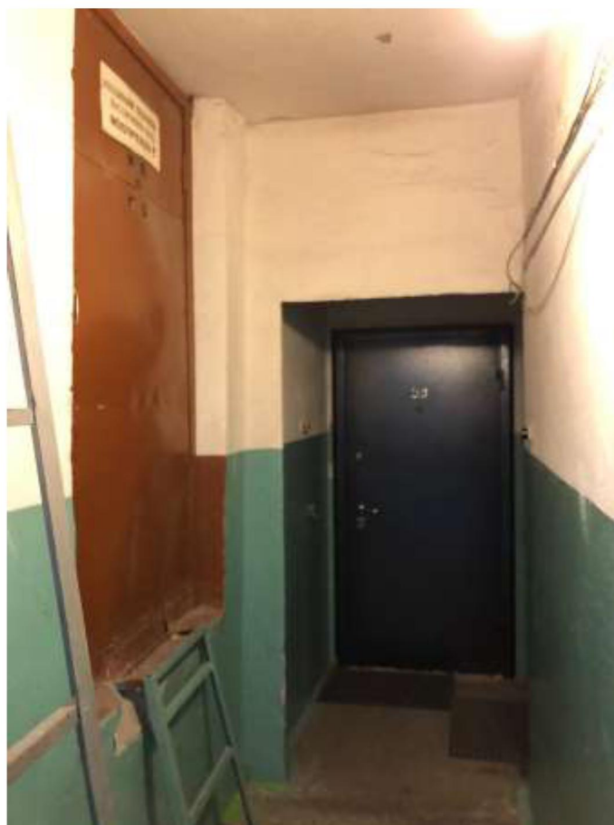
Рисунок 4 – Вход в машинное помещение
