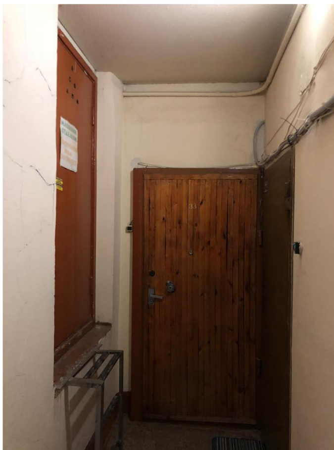
Рисунок 4 – Вход в машинное помещение
