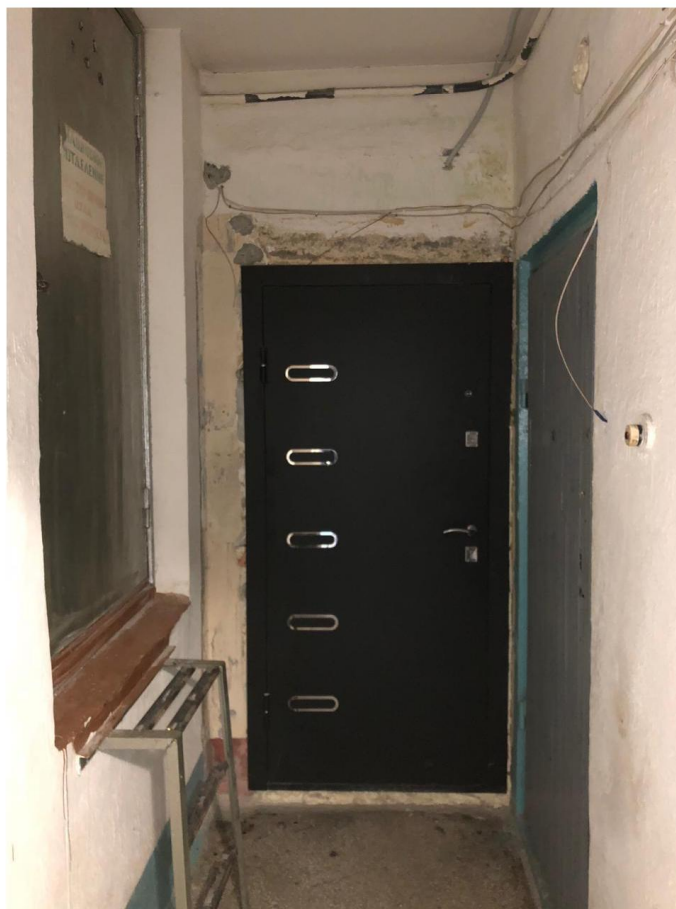
Рисунок 4 – Вход в машинное помещение
