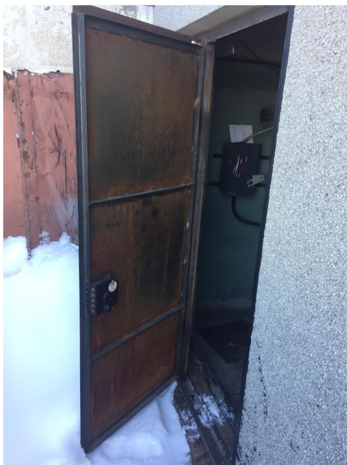
Рисунок 4– Вход в машинное помещение
