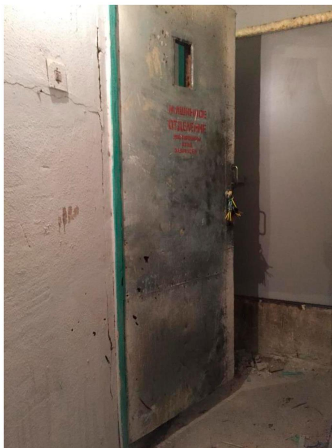
Рисунок 4– Вход в машинное помещение
