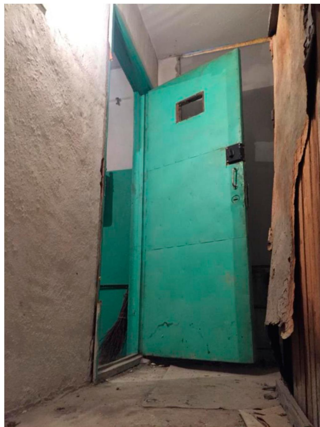
Рисунок 4– Вход в машинное помещение
