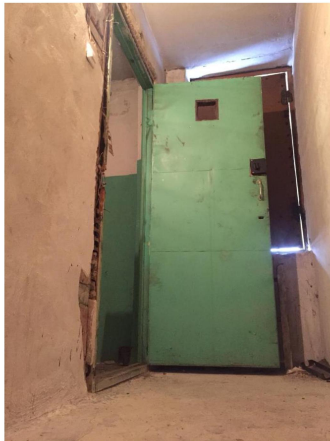
Рисунок 4– Вход в машинное помещение
