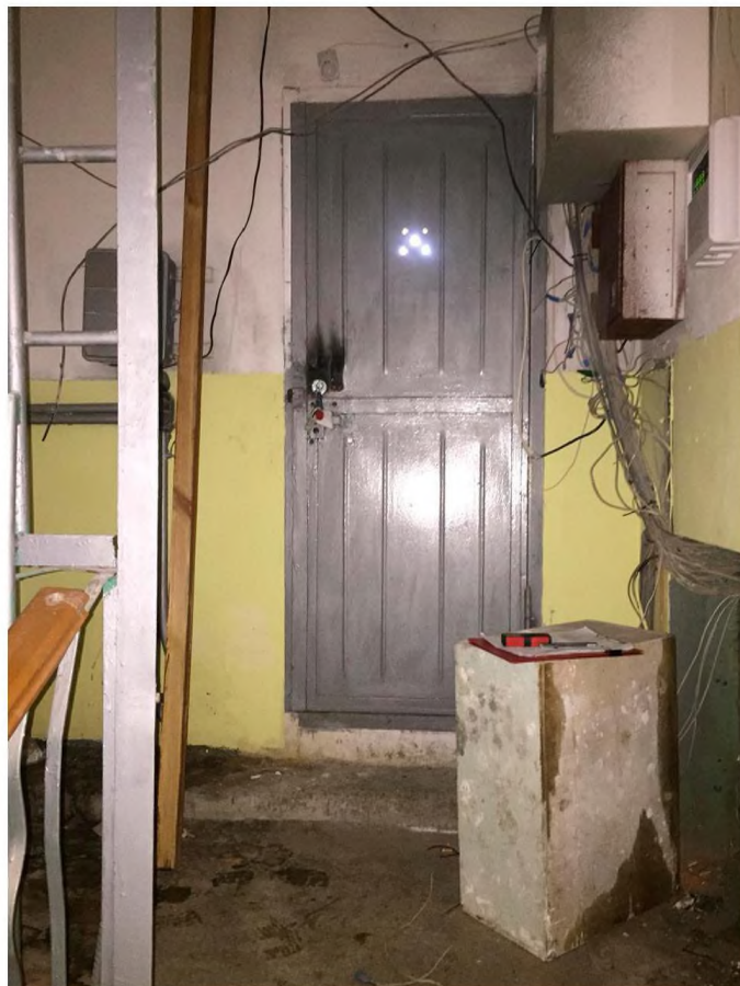
Рисунок 4– Вход в машинное помещение
