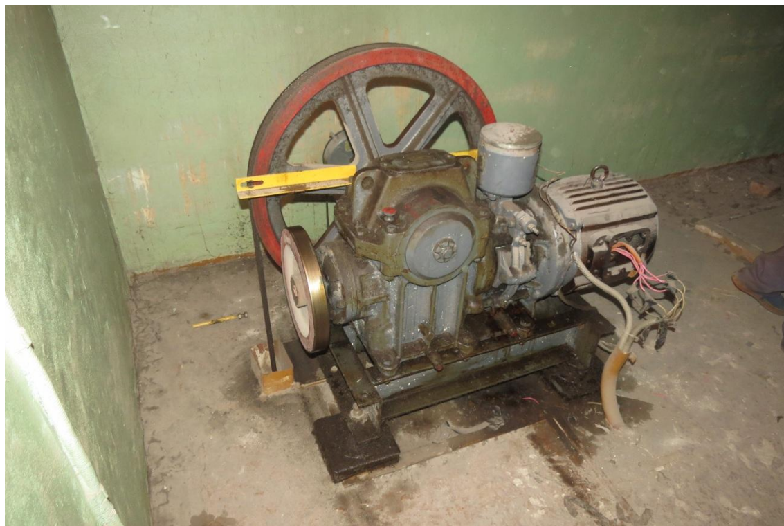
Фото Б6. Вид на лебедку лифта
