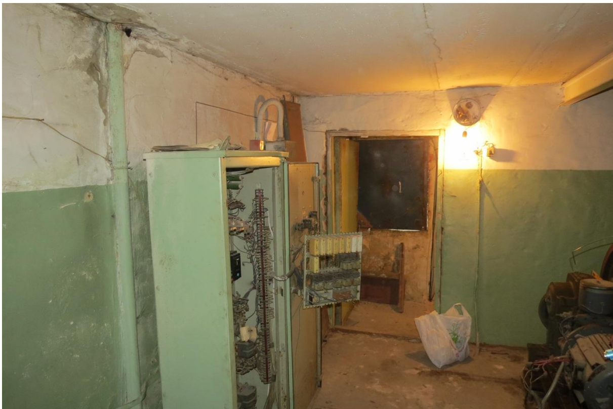
Фото Б3. Общий вид машинного помещения лифтовой шахты
