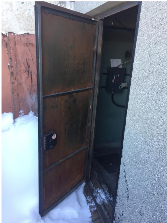
Рисунок 4– Вход в машинное помещение
