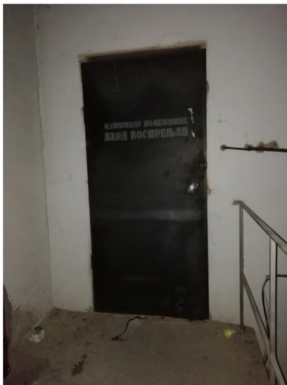
Рисунок 4 – Вход в машинное помещение
