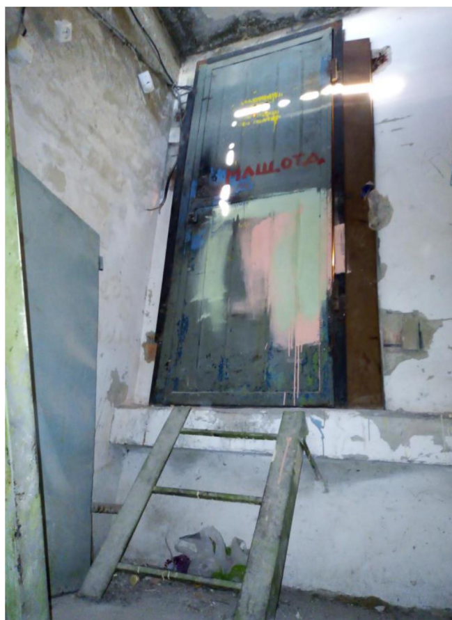
Рисунок 4– Вход в машинное помещение
