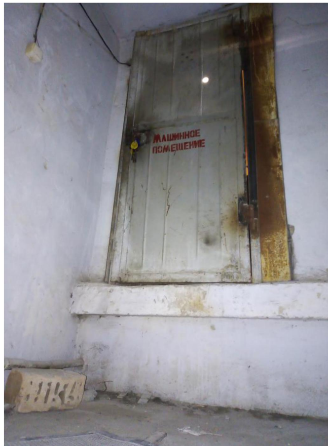
Рисунок 4– Вход в машинное помещение
