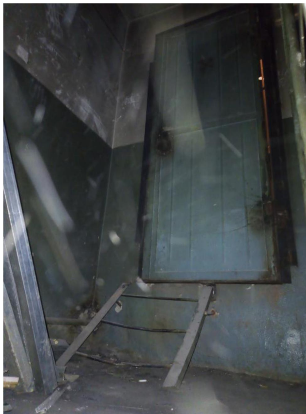
Рисунок 4– Вход в машинное помещение
