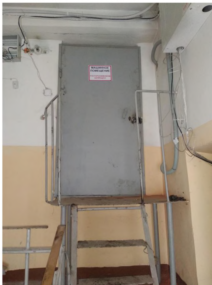
Рисунок 4 – Вход в машинное помещение
