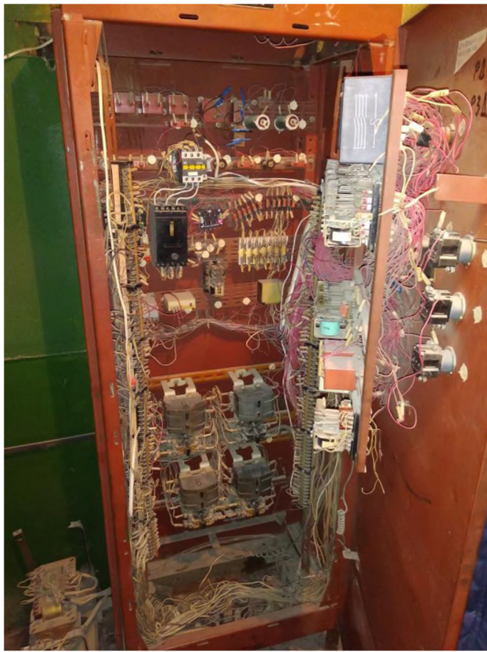
Рисунок 5– Шкаф управления и лебедка
