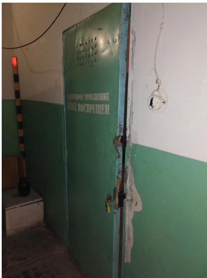
Рисунок 4 – Вход в машинное помещение
