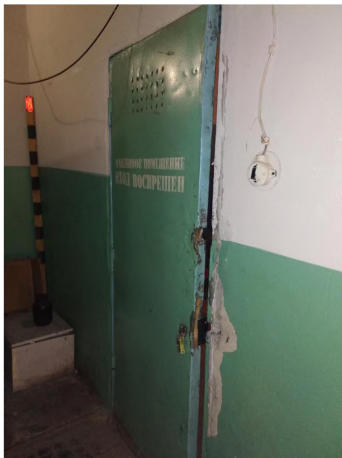
Рисунок 4 – Вход в машинное помещение
