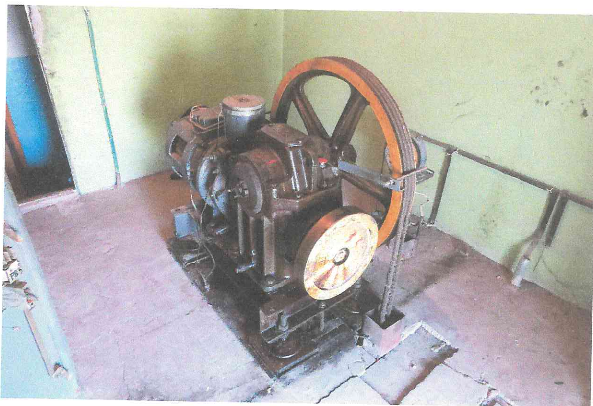
Фото А16. Вид на лебедку существующего лифта 1 подъезда
