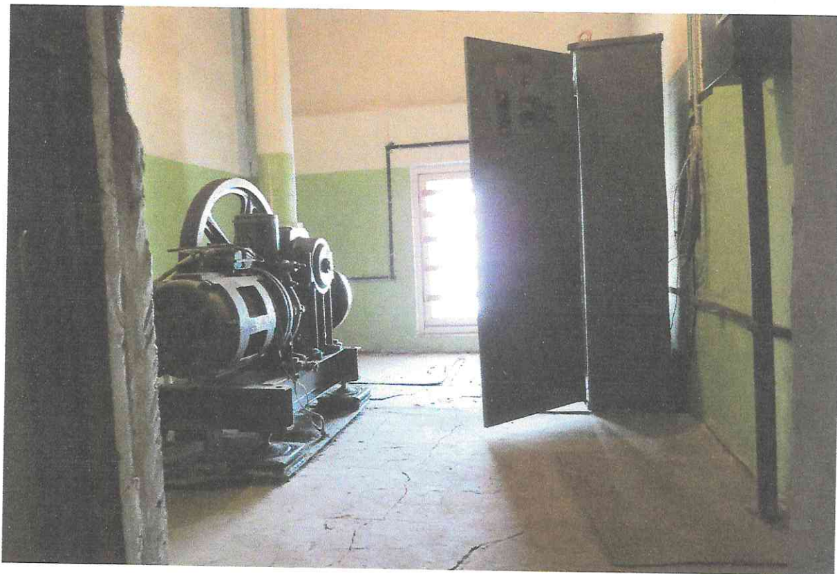
Фото А15. Общий вид машинного помещения 4 подъезда
