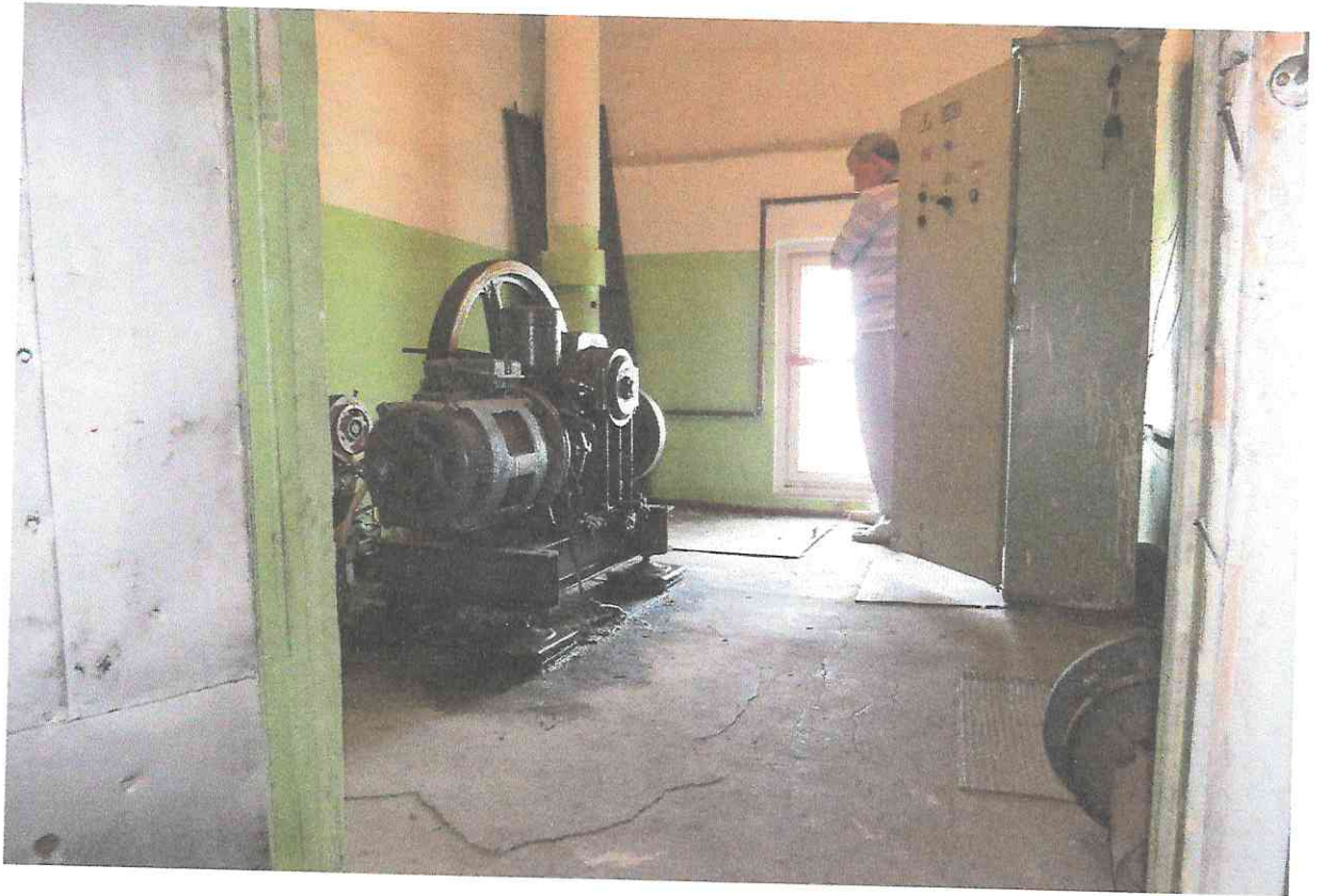
Фото А3. Общий вид машинного помещения 1 подъезда
