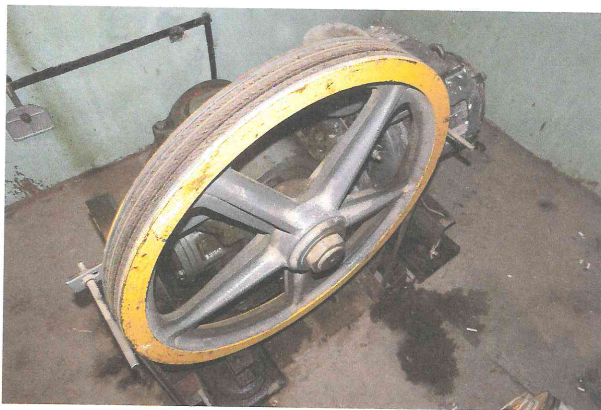
Фото А12. Вид на лебедку существующего лифта 3 подъезда
