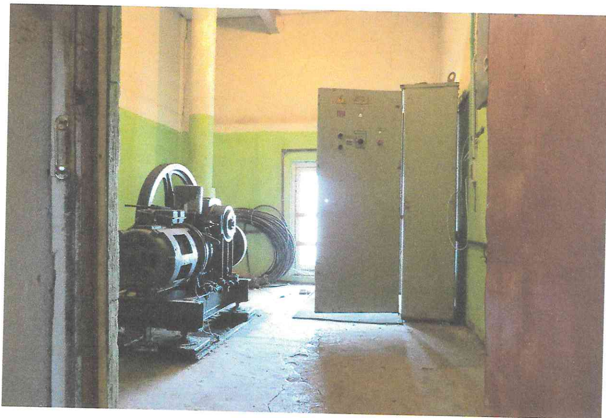
Фото А7. Общий вид машинного помещения 2 подъезда
