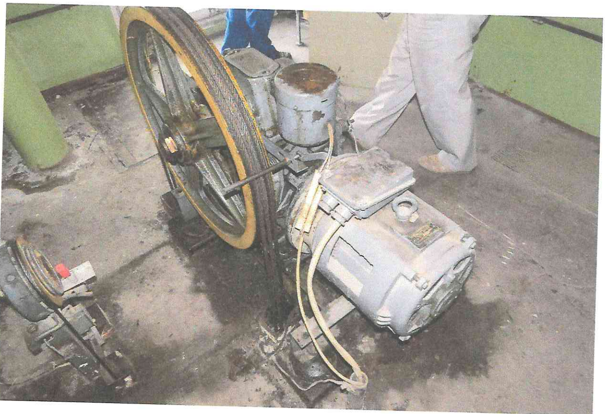
Фото А4. Вид на лебедку существующего лифта 1 подъезда
