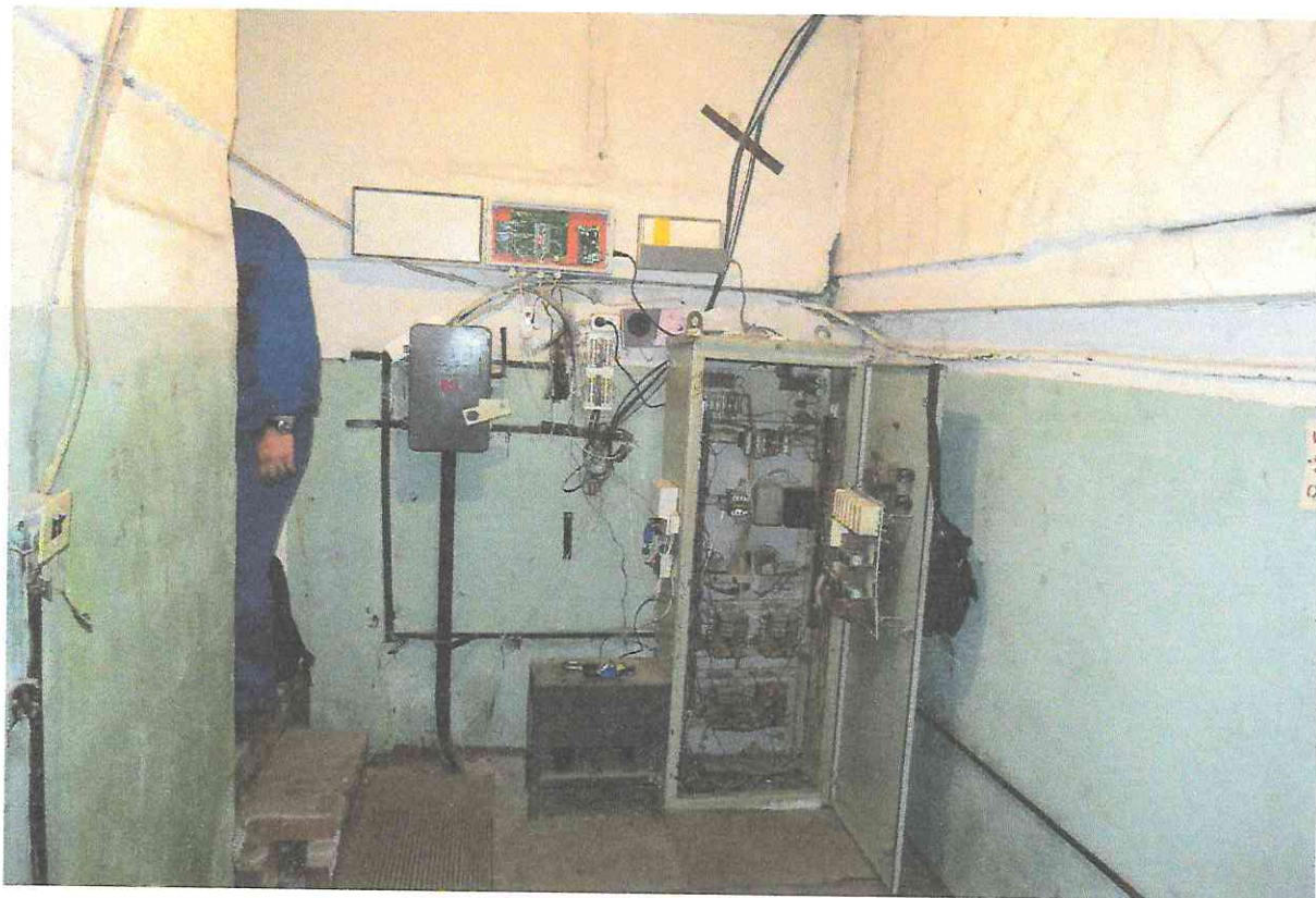
Фото А11. Общий вид машинного помещения 3 подъезда
