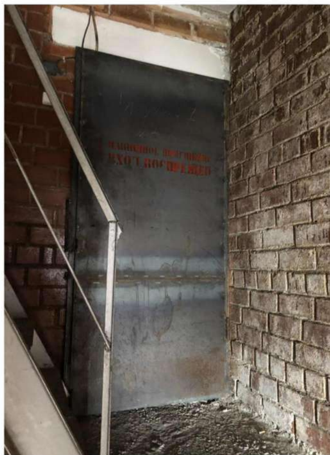
Рисунок 4 – Вход в машинное помещение
