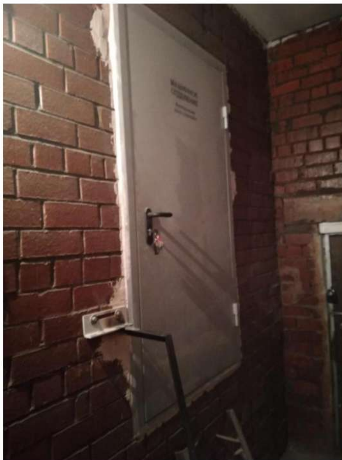
Рисунок 4 – Вход в машинное помещение
