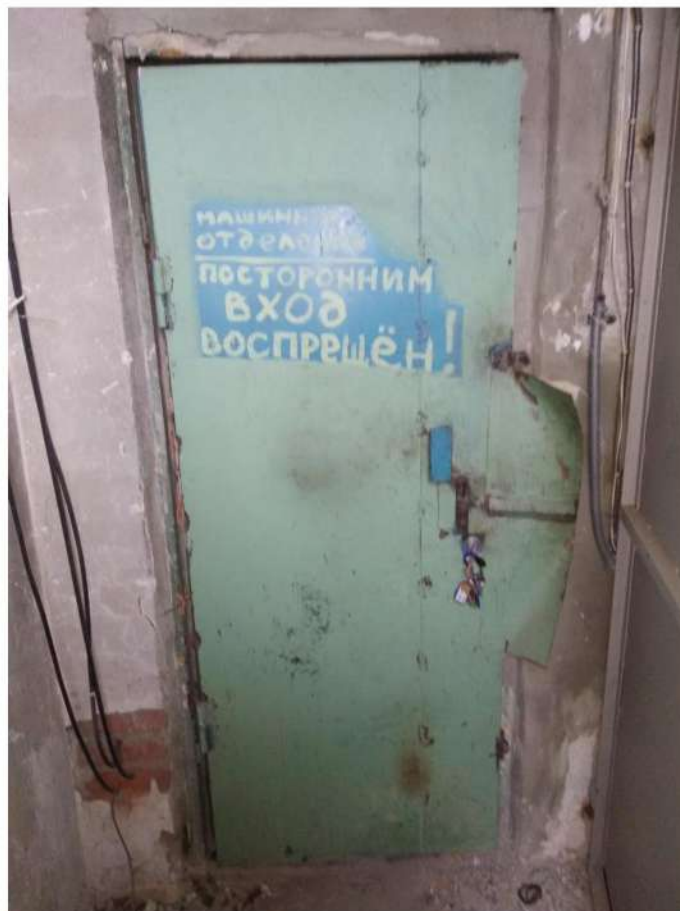
Рисунок 4 – Вход в машинное помещение
