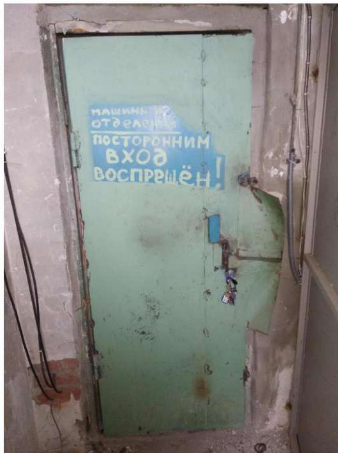
Рисунок 4 – Вход в машинное помещение
